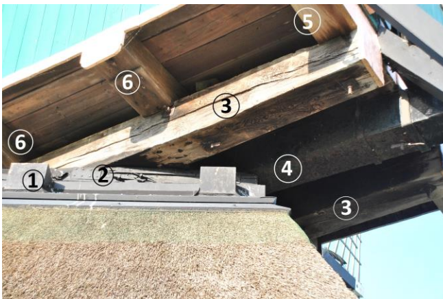
Het boventafelement (1) met daarop de onderzetel (2). Op de onderzetel rusten de voegburriebalken (3). Dwars op de voegburries liggen de achterzomer (5) en twee middenzomers (6). Tussen de voegburries de staart (4).
