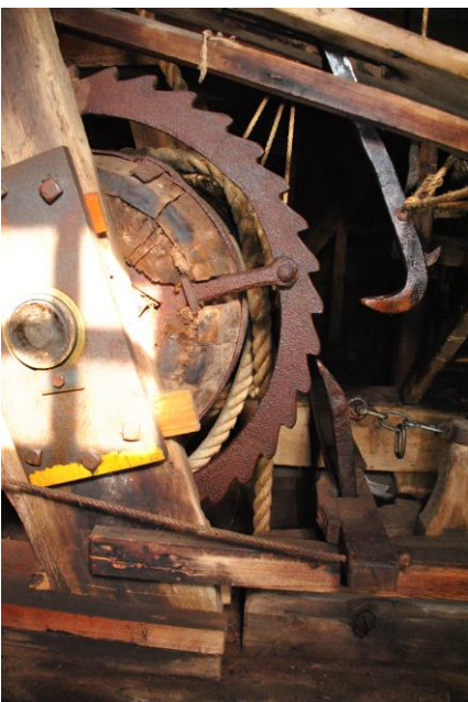
De winderij van een paltrok. We zien de tankrans met haler en pal. De Held Jozua - Zaandam
