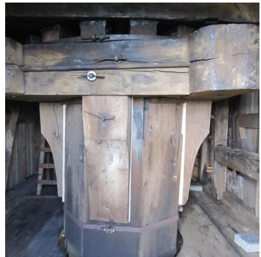
In het bovenhuis: de bovenzetel van een wipmolen. Rond de koker is – op vier zware consoles – de bovenzetel bevestigd. Hier zijn op de bovenzetel ook neuten aangebracht. Daarop rusten de steenburriebalken.
