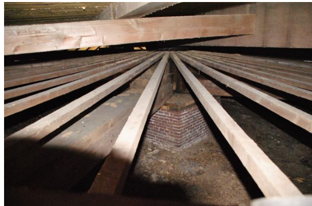
De gemetselde stiep (midden). Daarop liggen de koning en de kruisbalken. Daarboven de radiaal geplaatste spoorstokken die de rollenwagens ('de rolring') op hun plaats houden. Rechtsboven de staart- of sleutelbalk
