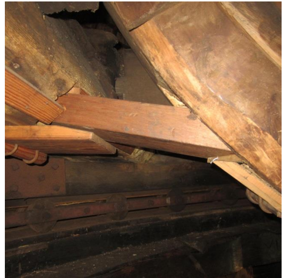
Afb.6 De stut , tussen linker voeghout (l) en teenstuk (r), opgesloten in stutkasten . De vang drukt buitenwaarts en omhoog tegen het linkervoeghout.
