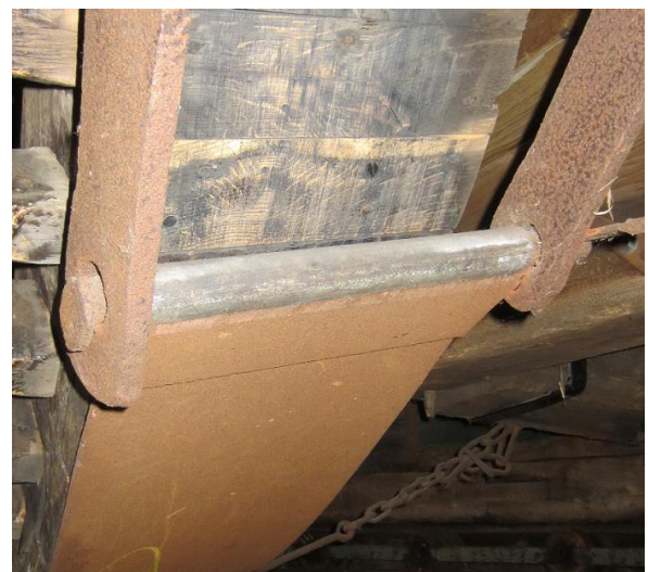
Afb.8 Een stalen bandvang ; hier is de bevestiging aan het vanganker te zien. Rondom het bovenwiel belegstukken . Rechtsonder een ketting voor de positionering.
