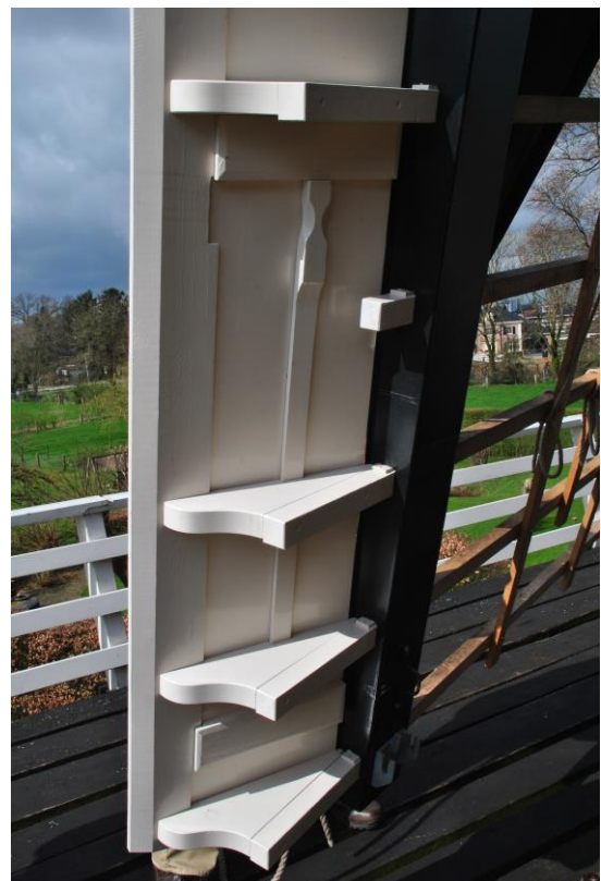
Afb.2 Op de uiteinden van (verlengde) heklatten kluften om een schuine stand van de windborden te krijgen. Het windbord is vastgezet met een bordveer .
