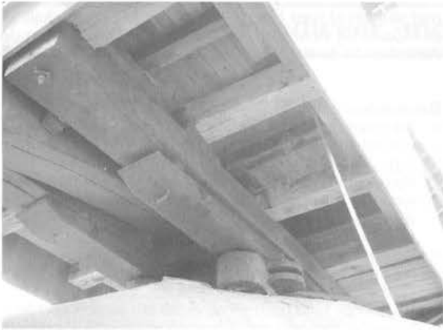
De slekken onder de voegburrie balken
