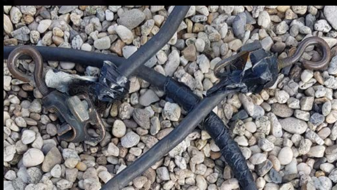
Kabels van het oude type.
