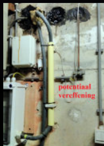
Afb. 3. Een potentiaalvereffening verbindt de aarde van de elektra met de aarde van de bliksemafleider
