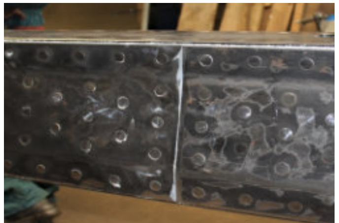
Afb 12. Afgeslepen klinknagels bij een overgang van platen met een verschillende dikte.
