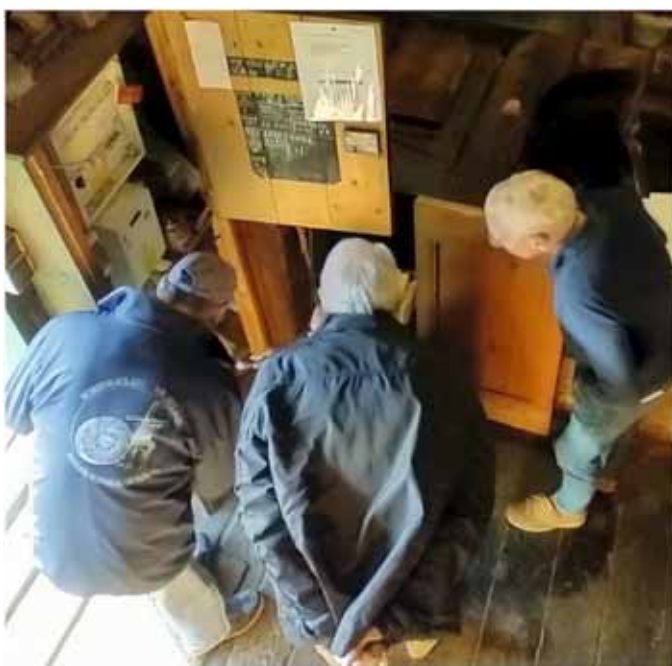
De controle begint bij de meterkast
