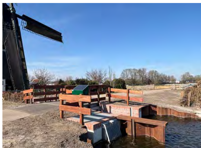
De inlaatklep is geautomatiseerd en voorzien van een zonnepaneel.
